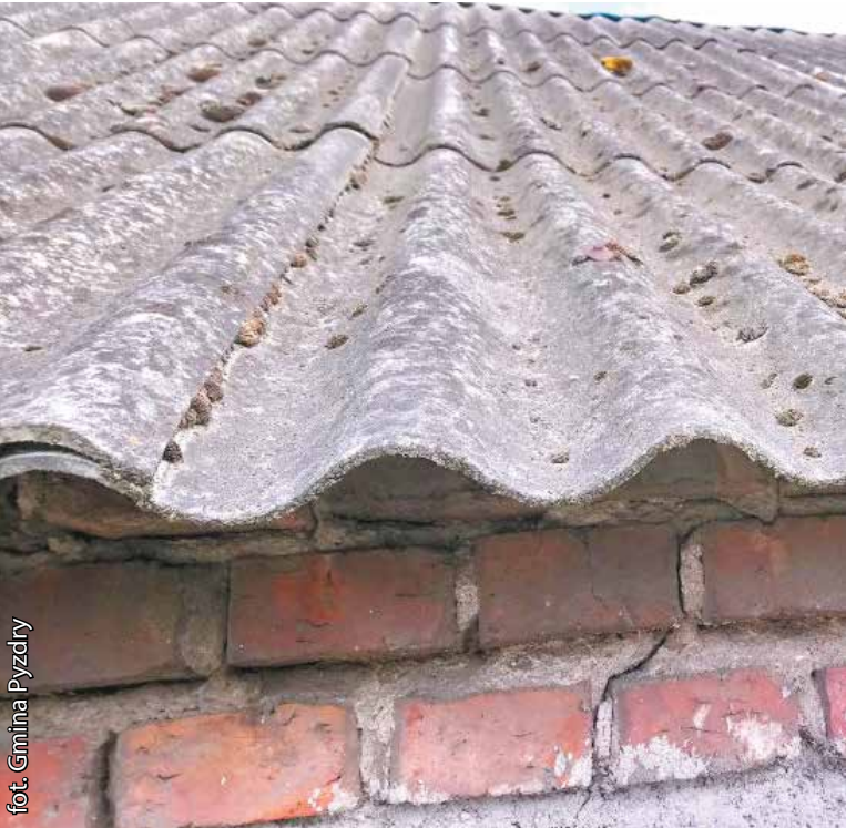
Eternit to azbestowo-cementowy materiał budowlany
